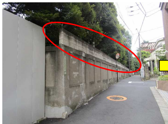
(改善前) 附属高等学校ブロック積み C
